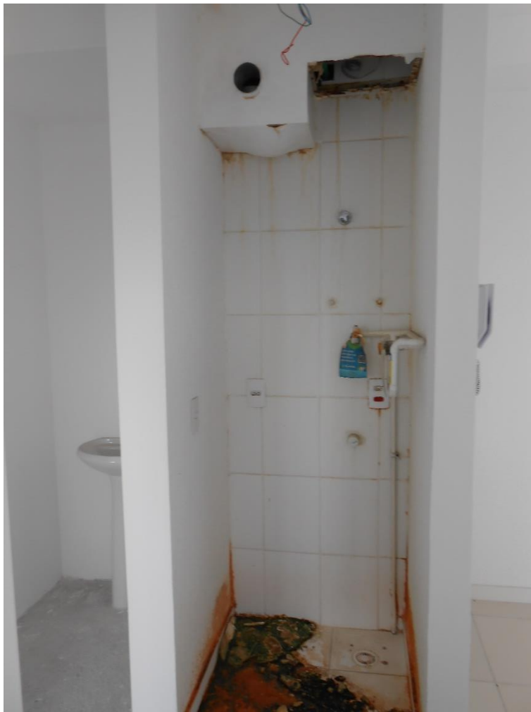
Foto 1: Área de serviço danificada
