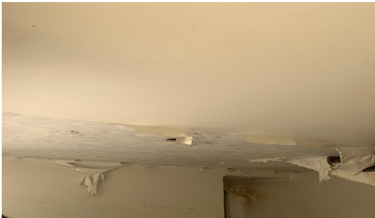
Foto 12 - A tinta do forro está descascando.
